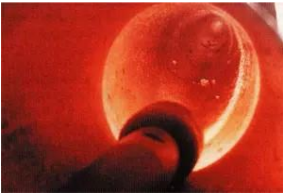
Afbeelding 4 Inwendige van corroderende waterleiding. Let op de roestpokken die zich vooral rond de 6 uur positie bevinden. Foto: www.corrosie.nl
