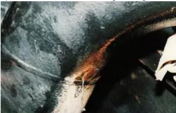
Afbeelding 3 Lekkage in een roestvaststalen waterleiding ten gevolge van corrosie die is geïnitieerd door srb's. Foto: www.corrosie.nl
