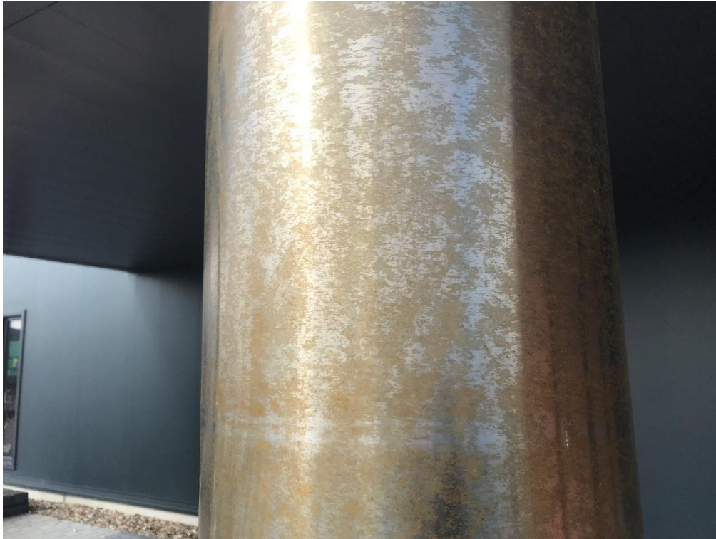
Roestige theevlekken op roestvast staal 316 in de buitenlucht
