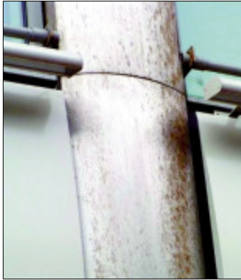
Door de grover geslepen finish corrodeert de verticale beplating sneller
