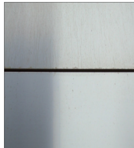
Het onderste inox paneel is reeds behandeld met (mild) zure reiniger, op het bovenste is nog duidelijk de aantasting door corrosie te zien
